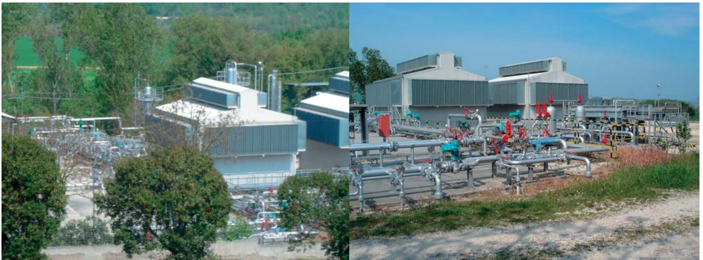
Compressori gas naturale e collettore arrivo gas naturale dai pozzi
