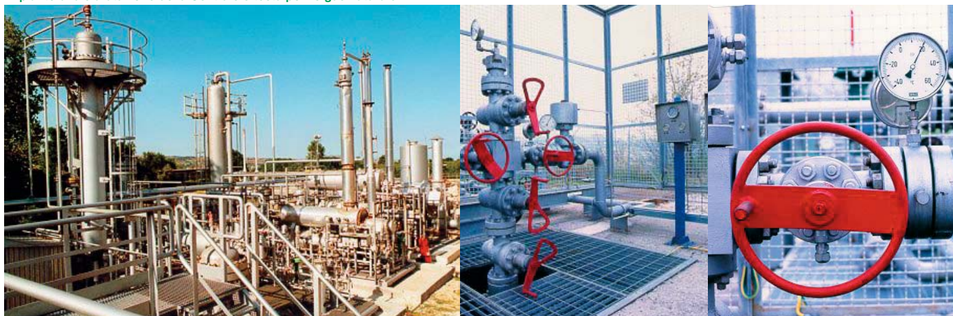
Impianto di disidratazione della Centrale e testa pozzo gas naturale
